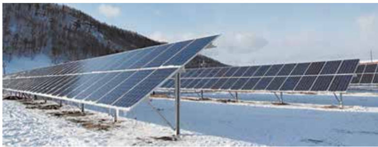
Солнечная энергоустановка в селе Менза Забайкальского края
