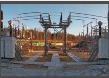
Реализация объектов ВАПС III архитектуры. ОРУ-110 кВ высоковольтной электрической ПС 110 кВ ГПП-9
