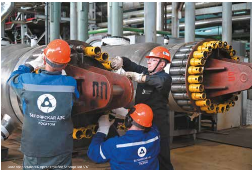
Фото предоставлены пресс-службой Белоярской АЭС
